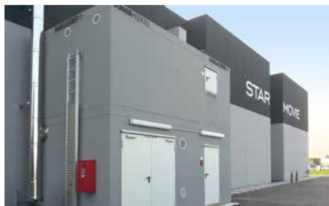
Dvoupatrový topný kontejner na štěpku u veřejné budovy.
