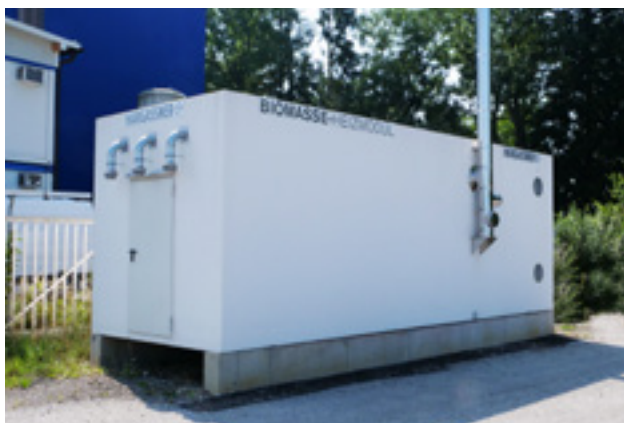
Patrový topný kontejner 120 kW pelety, průmyslový objekt
